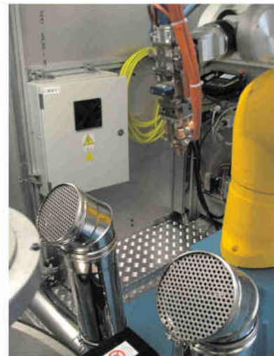
Bocchette di aspirazione fumi interne Fumes suction vents
